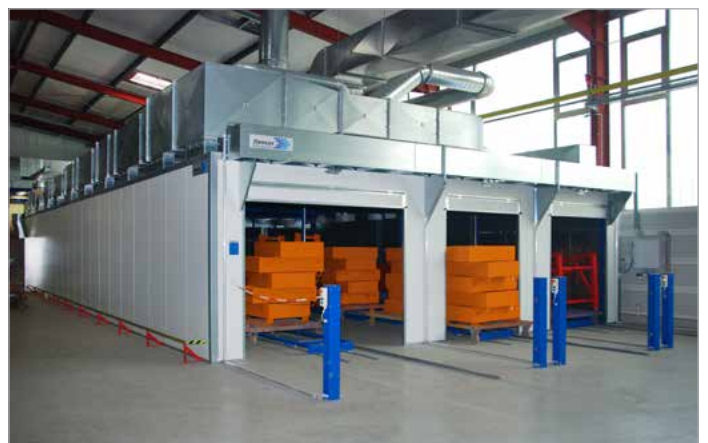
Lackiererei mit Trocknungsstraße
